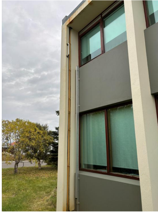
Mynd 11: Ryð og ryðsmit frá þakrennu og þakáfellu.
