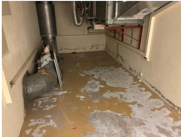
Mynd 6: Flögnun á málningu á gólfum og neðri hluta veggja í kjallara ásamt sprungum í gólfplötu.
