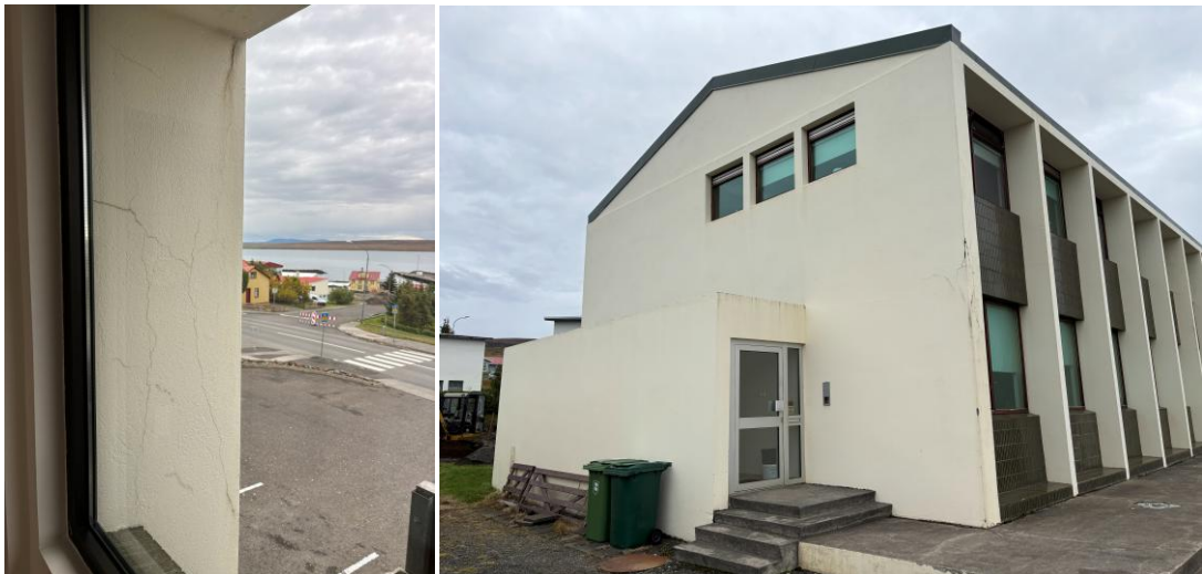
Myndir 12 & 13: Sprungumyndun í steypu burðarvirki.
